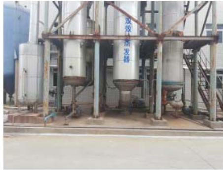
双效蒸发器区域防渗措施完善情况
