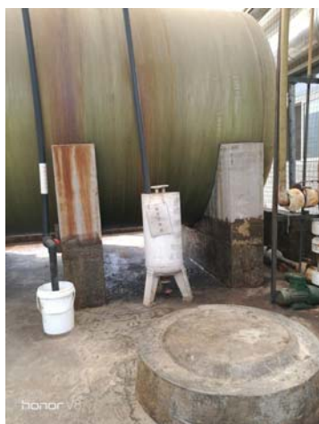
碱液吸收装置
