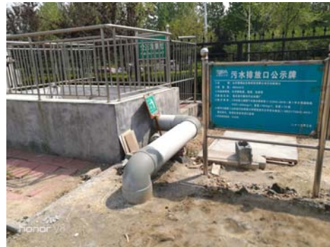
污水排放口标示牌
